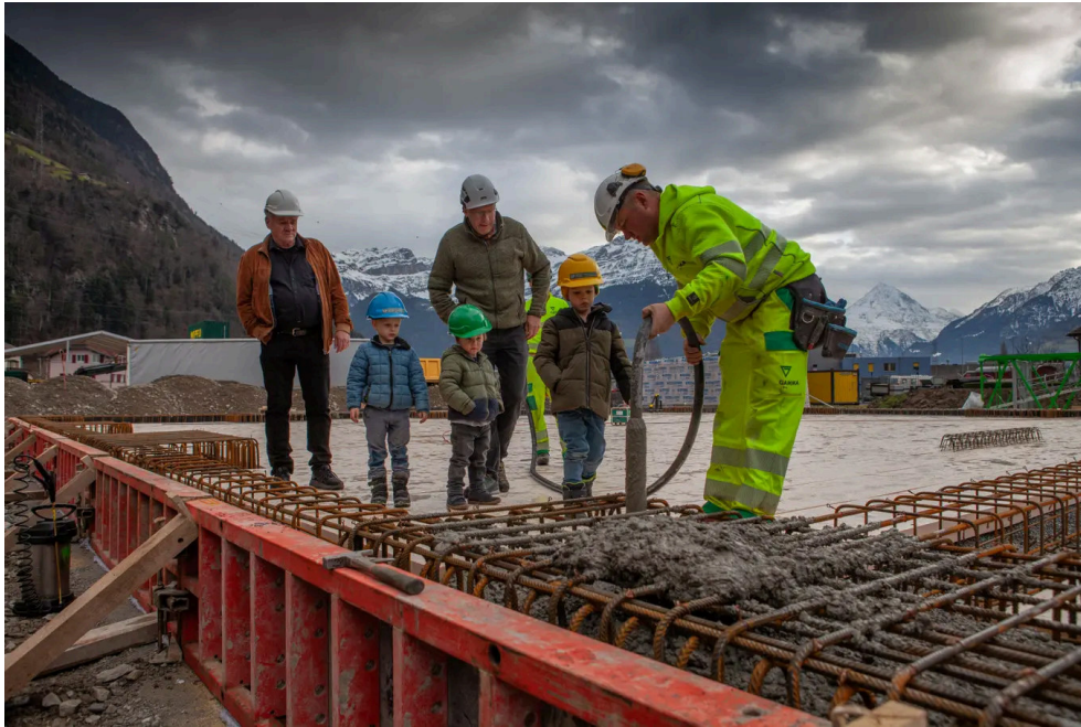
Die Box wird im Beton versenkt: Christoph Schoop (links) und Hermann Herger mit seinen Grosskindern sowie einem Mitarbeiter der Baufirma. Bild: Florian Arnold (Flüelen, 18. 12. 2024)
